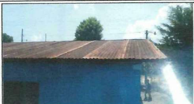
Foto 1: Cubierta de lámina, se encuentra en mal estado.
