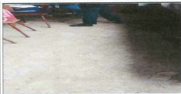
Foto 5: Sustitución de piso, el piso no es adecuada para recibir clases y estan en mal estadas.
