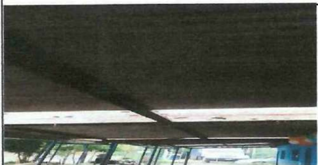
Foto 3: reparación de estructura de techo, las estructuras estan en mal estado
