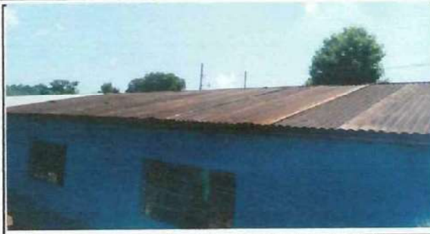
Foto 2: Canales y bajadas pluviales, no existe las bajadas pluviales ni canales.
